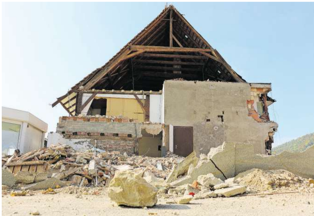
Bis heute eine Bau ruine: der historische Murihof kurz nach dem Abbruch 2018.
